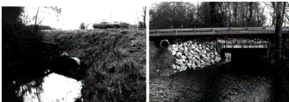
Photos 13 et 14 : Le pont de "la Duchée" avant et après travaux (Photo Parc naturel régional de Brière).
