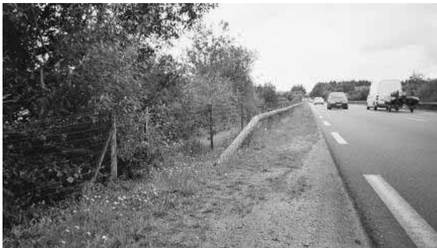
Photo 18 : L'aménagement mis en place en 1992 sur la RD 780 dans le Morbihan (cf. \alpha 3 p. 13) avait nécessité la pose d'engrillagements complémentaires sur 250 m. des deux côtés de la chaussée ; à l'extrémité de l'un d'eux, il fut décidé d'installer un portillon à fermeture automatique pour faciliter le passage des pêcheurs : faute d'entretien régulier, ce portillon s'est dégradé et a ensuite disparu (à gauche sur la photo), rendant ainsi inopérant le principe \zeta d'étanchéité d'accès de la faune \Xi vers l'emprise routière (photo L. Lafontaine).
