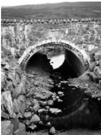
Photo 6 : Mesure compensatoire pour la loutre en Écosse (Ile de Skye) : berge artificielle bétonnée sous ouvrage.(photo L. Lafontaine).
