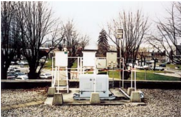
Station de prélèvement d'air de l'OPRI au CEA-Grenoble
