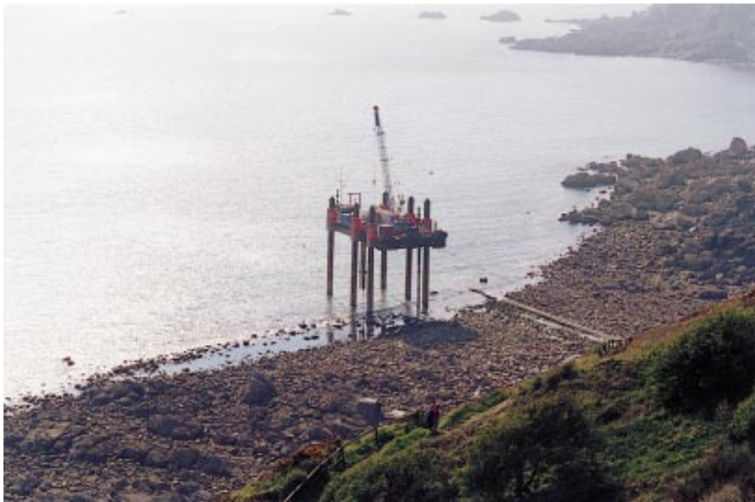
Travaux sur la canalisation de rejets à partir de la plateforme « Ile d'Oléron »
