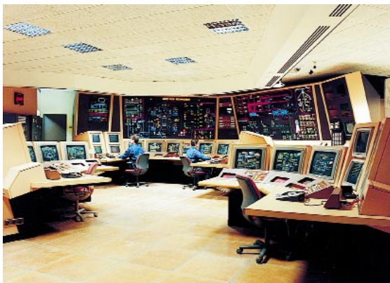
Vue générale de la salle de commande N4
