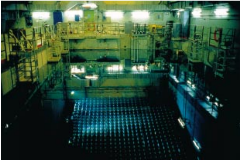
APEC : piscine de désactivation
