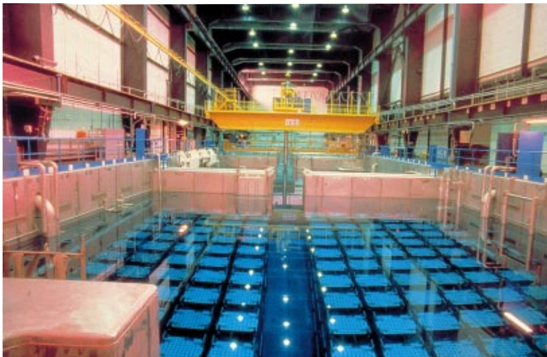
Etablissement COGEMA de La Hague : piscine NPH, contenant notamment du combustible MOX
