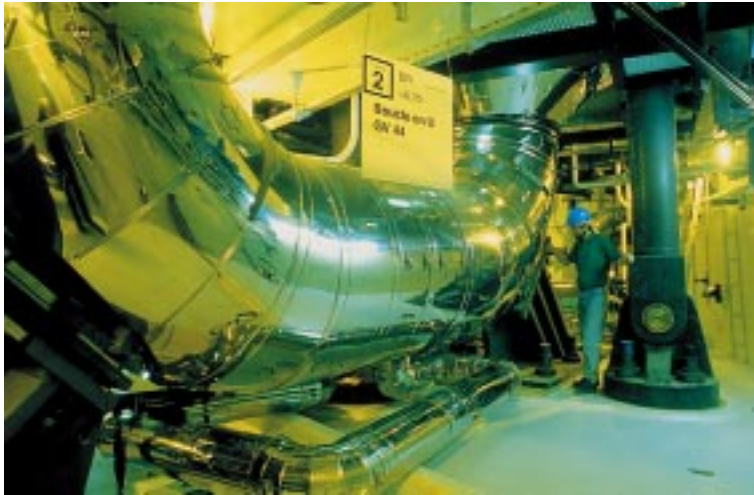
Tuyauterie primaire : une branche en U avec le piquage de la ligne de décharge RCV (circuit de contrôle chimique et volumétrique)
