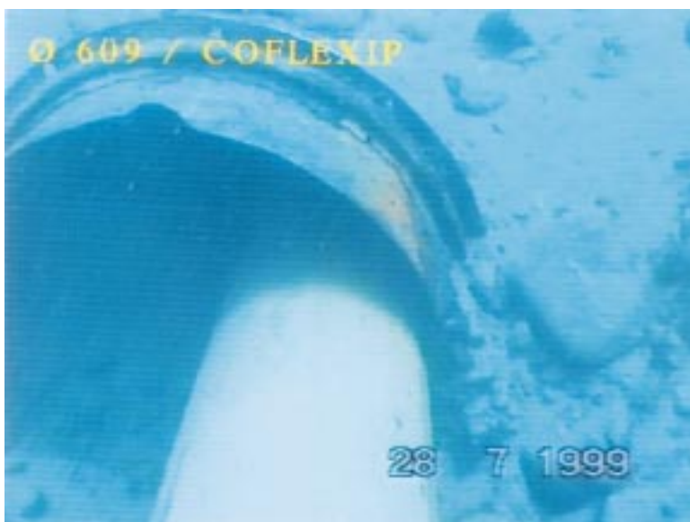
Flexible Coflexip de la canalisation en sortie de fourreau métallique
