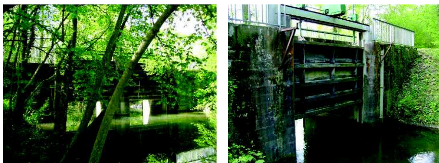
Aménagement d'ouvrages à vannes sur le Langgiessen (à gauche) et le Kuppengrün (à droite), à leur passage sous la digue des hautes eaux du polder d'Erstein, permettant notamment l'inondation occasionnelle de certains secteurs du polder
