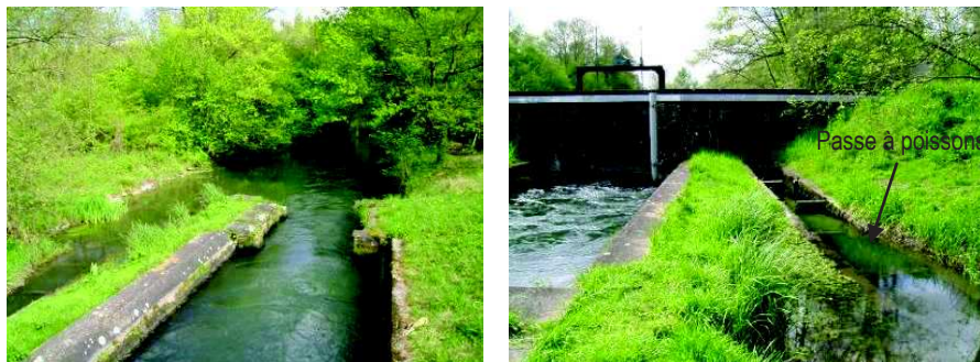
Ouvrage de prise d'eau : le Langgiessen, alimenté ici par les eaux du Canal d'alimentation de l'Ill. Afin d'atténuer la coupure générée par l'ouvrage, une passe à poissons a été réalisée.
